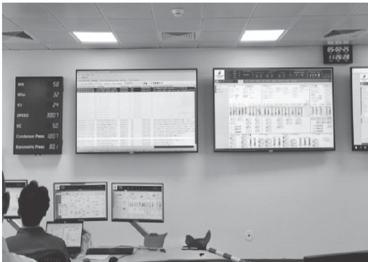
Nhà máy điện Nhơn Trạch 3, nhà máy điện khí LNG đầu tiên của Việt Nam hòa lưới điện thành công đạt công suất 50 MW.
